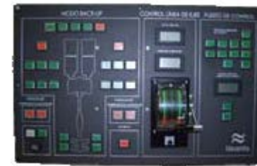
Paneles de Operación Remota
