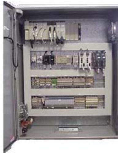
Subestaciones locales (LSS, Local SubStation)
